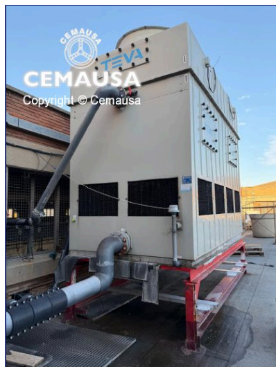
Aeroenfriadores de 1200 kw
