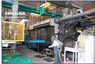
Inyectora termoplástico 1800 ton.
