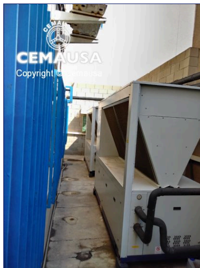
Grupo refrigeración agua
